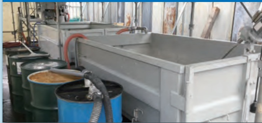
反応槽、中継槽、石綿圧縮回収ドラム缶 ③・④・B
